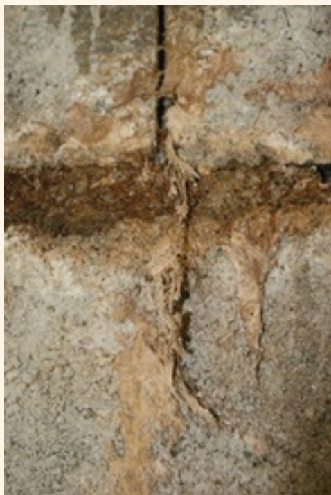
Figure 5 : Exemple de cordons mycéliens sporophores s'infiltrant à travers les joints de maçonnerie Source : Patrick Laurent
